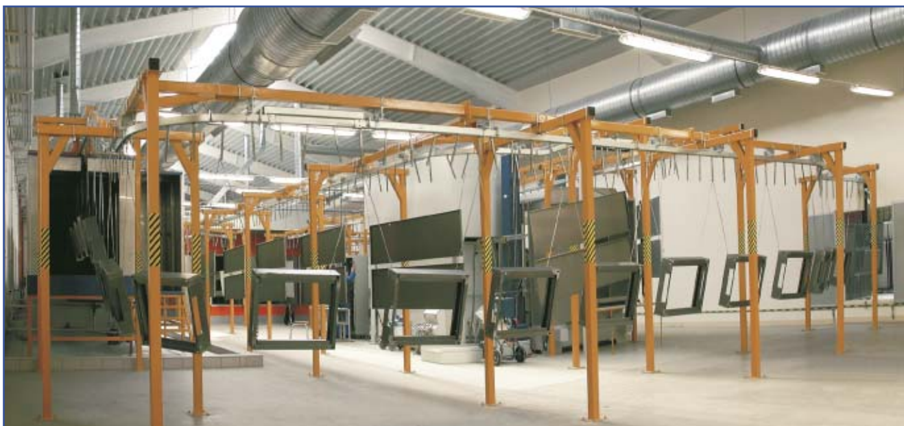
Zautomatyzowana lakiernia proszkowa
